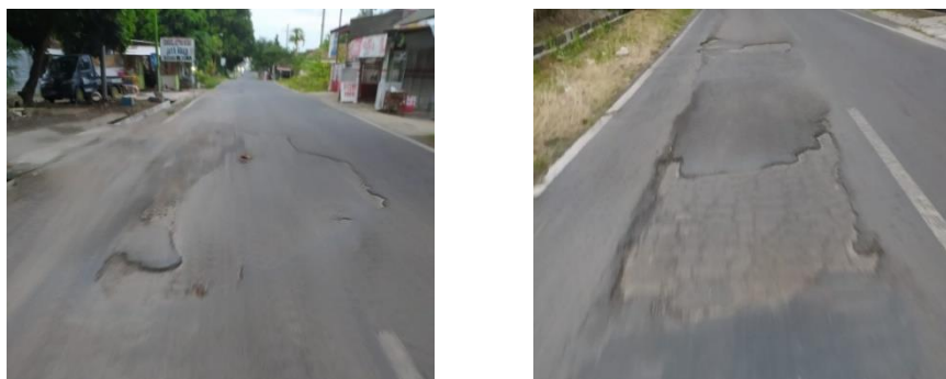
Gambar 2. Kerusakan jalan akibat aktivitas truk tambang pasir
